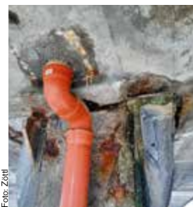
Der Rad- und Fußgängerübergang am Posthofberg weist deutliche Schäden auf und muss erneuert werden.
