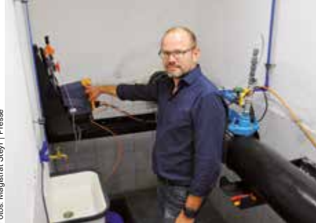
Das vom Trinkwasserexperten der LINZ AG DI Martin Pellegri installierte Chlorungsgerät soll noch im Jänner vom Netz gehen.
