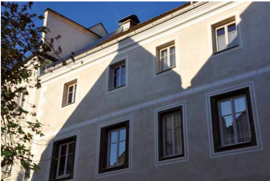
Beim Bürgerhaus Gleinker Gasse 20 wurden die Fassade und die Fenster vorbildlich saniert.
