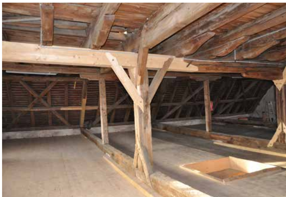
Im Dachstuhl wurden morsche und stark beschädigte Holzverbindungen und Sparren nach den alten Zimmermannstechniken mit Holznägeln und Dübeln saniert. Das Bild zeigt einen Knotenpunkt am Dachstuhl.
