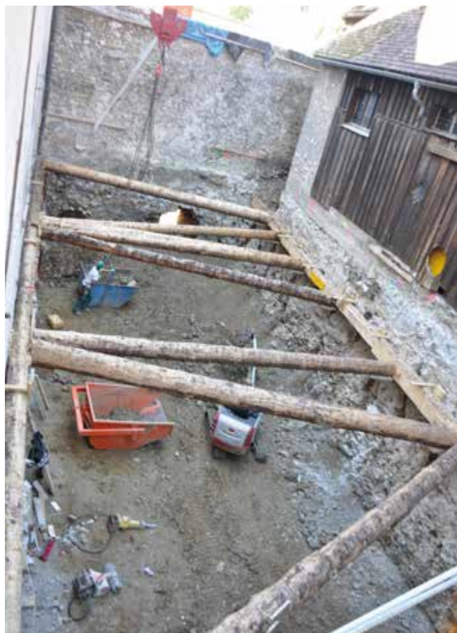
Um die Baugrube im rückwärtigen Innenhof ausheben zu können, mussten die Seitenwände gestützt werden.
