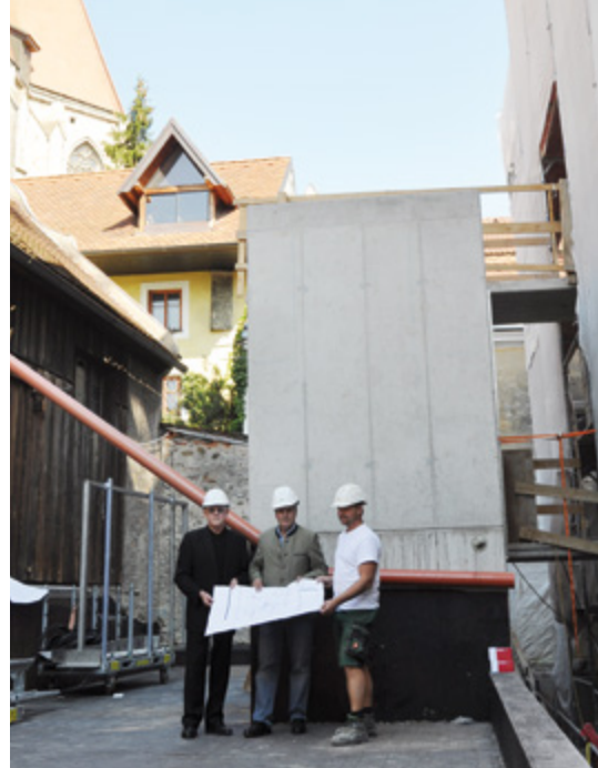
Der Umbau des Stadtmuseums beim Neutor schreitet zügig voran. Auf dem Foto (von links): Kulturamtsleiter Mag. Dr. Augustin Zineder, Stadtrat Gunter Mayrhofer und Gottfried Loibl (zuständiger Polier, Fa. Mayr Bau) im Hinterhof, in dem der Lift (Bildmitte) installiert wird.
