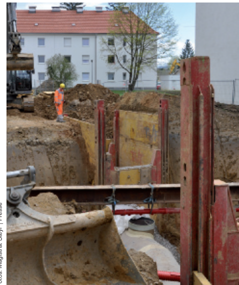
Mit dem hier gesetzten Schacht wird der Kanal Azwangerstraße an den Ableitungskanal Tabor angeschlossen.
