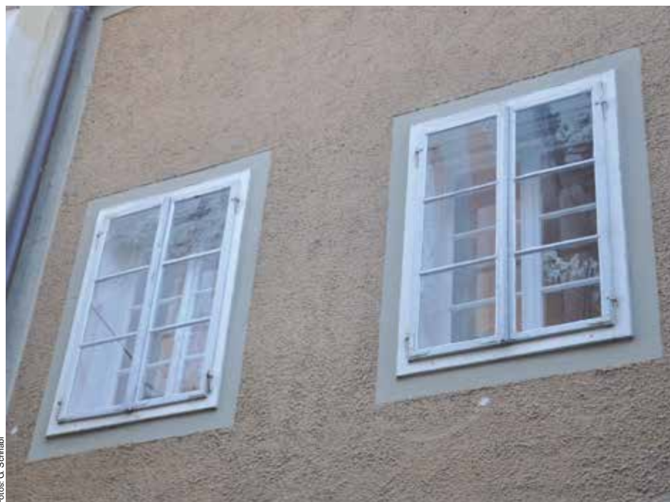
Fassadenbündiges Kastenfenster mit nach außen aufschlagenden Flügeln und zum Teil handgezogenen Gläsern.
