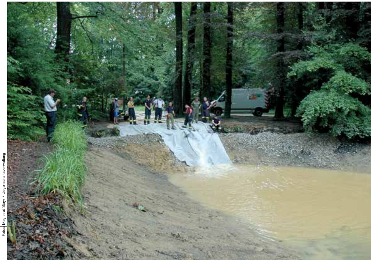
Mit vier, je 300 Meter langen Schlauchleitungen wird Wasser vom Museumssteg weg aus der Steyr in den Schlossparkteich gepumpt.
