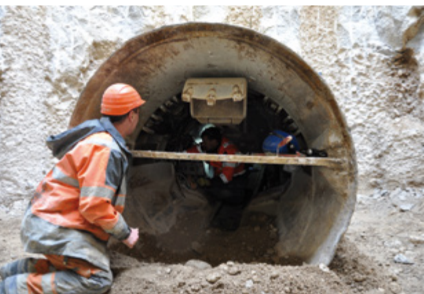
Am anderen Ende angekommen: Durchstich in der Zielgrube am Posthofberg im Bereich der ehemaligen Reeh-Villa.
