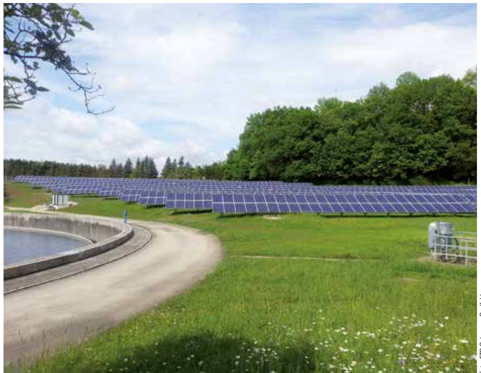
Die größte Photovoltaikanlage Österreichs bei einem kommunalen Umweltbetrieb wird am 24. Juni auf dem Gelände des Reinhaltungsverbandes Steyr und Umgebung eröffnet. Die Eckdaten der Anlage: 9250 m 2 verbaute Fläche, 1550 Module, drei Wechselrichter zu je 100 kW, ein Wechselrichter 75 kW, Wirkungsgrad 90 %, Investitionskosten ca. 600.000 Euro, Amortisationszeit berechnet ohne Förderung: ca. 15 Jahre
