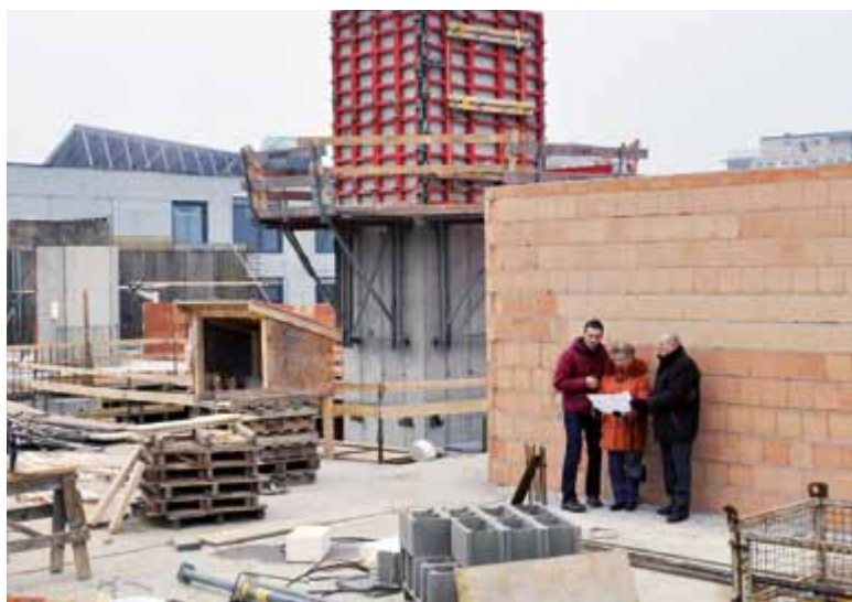
Interessierte erkundigen sich auf der Baustelle über Betreutes Wohnen. Voraussichtlich im Spätherbst wird das Gebäude eröffnet.
