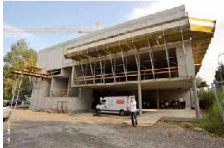
Im Stadtteil Resthof wird eine 8-klassige Volksschule errichtet, vor kurzem fand bereits die Gleichenfeier statt. Das Gebäude besteht aus drei Geschoßen, wobei der Mehrzwecksaal im Erdgeschoß geplant ist. Die Volksschule soll im Schuljahr 2010/2011 bereits zur Verfügung stehen.
