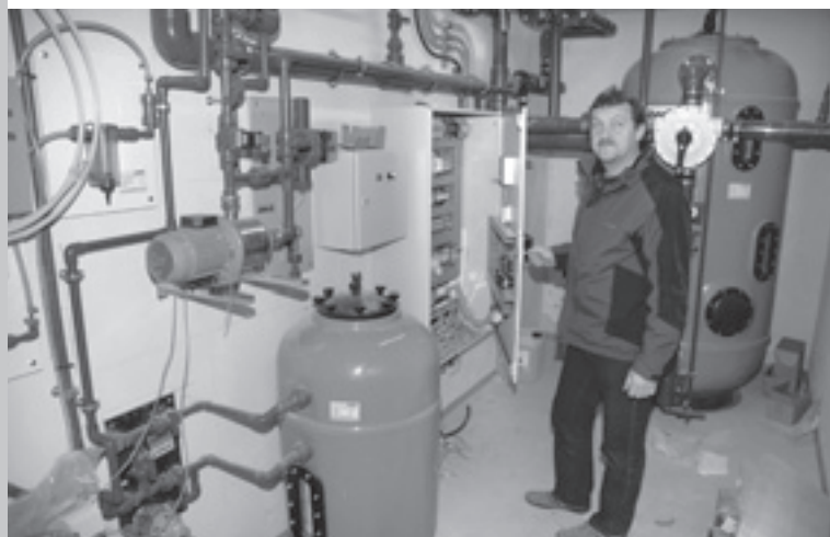
Die technische Anlage für die Wasseraufbereitung des Whirlpools, rechts im Bild Betriebsleiter Günter Großauer.
