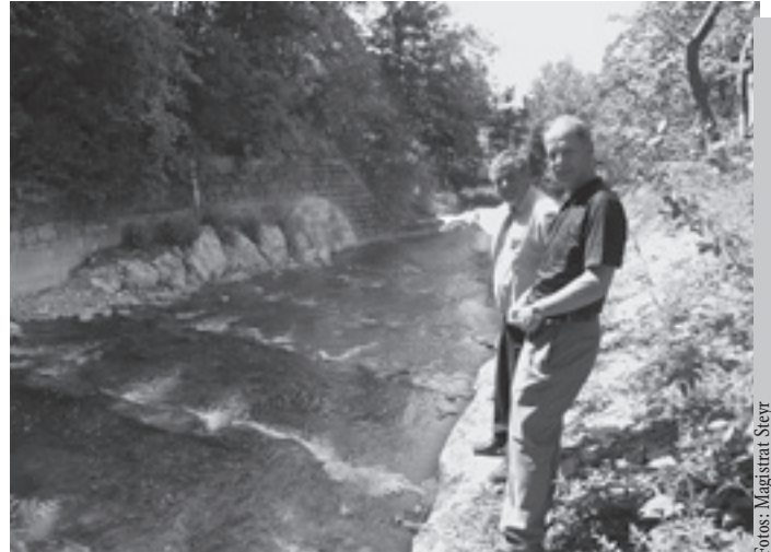
Mit dem 2. Bauabschnitt – Abbruch der Griemühlwehr und Tieferlegung des Bachbettes – sind nun die Hochwasserschutzmaßnahmen am Ramingbach im Stadtbad-Bereich abgeschlossen.
