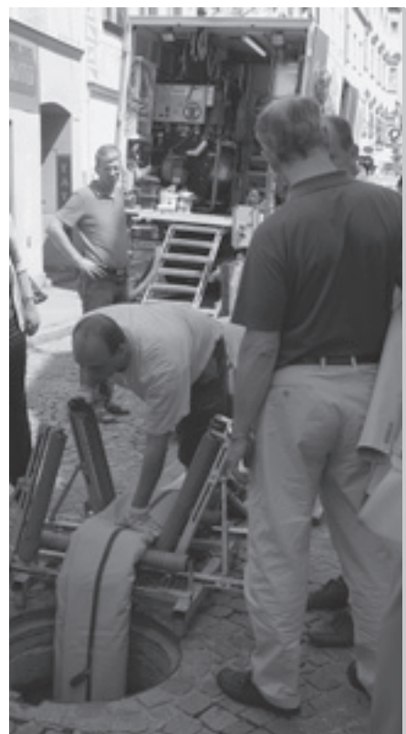
Kanal-Sanierung ohne Grabung – auf dem Foto sieht man, wie der Schlauch aus Glasfaser und Harz in das alte Kanalrohr abgelassen wird.
