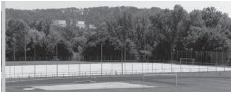
Sanierung des Kunstrasenplatzes auf der Sportanlage Rennbahn: Auf dem Foto ist der aktuelle Stand zu sehen – der alte Belag ist bereits abgetragen, die weiteren Arbeiten werden planmäßig bis Herbst abgeschlossen sein.
