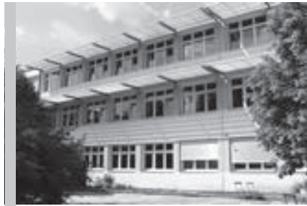
An der HS Tabor ist zum Beispiel ein Vollwärmeschutz aufgebracht worden, außerdem hat man die seit Bestehen der Schule vorhandenen Fenster durch wärmetechnisch geeignetere ersetzt und die Eingangsportale erneuert.
