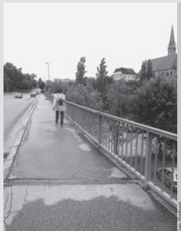
Der Gehsteig und die Fahrbahnübergangs-Konstruktionen der Schönauerbrücke müssen erneuert werden. Die Bauarbeiten beginnen voraussichtlich am 21. Juni.
