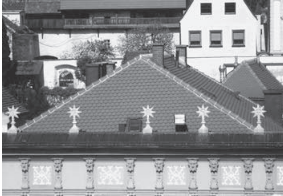
STADTPLATZ 30: Bei diesem Gebäude handelt es sich um ein im Kern spätgotisches Haus mit Arkadengang im Hof und einer stuccierten Fassade aus dem zweiten Viertel des 18. Jahrhunderts. Die gesamte Anlage ist neu eingedeckt worden. Deutlich sichtbar sind die (nach historischem Vorbild) in Mörtel verlegten Firstziegel. Im Zuge der Dacherneuerung sind auch die für dieses Haus so charakteristischen Sterne fachgerecht restauriert worden.
