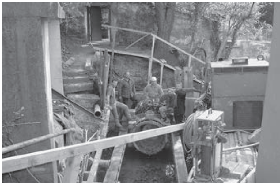
Beginn der Bohrung unterhalb des Wiesenberges - Blick auf die Pressgrube und das Bohrgerät.
