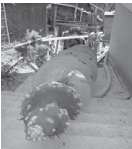
Der Bohrer mit einem Meter Durchmesser wird in einem Stahlrohr geführt, während er das Material abbaut.
